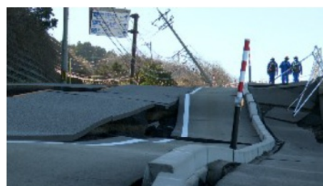
地震により通行止めとなった主要道路
