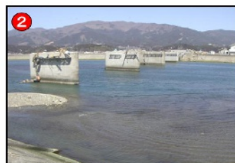
岩手県陸前高田市国道 45 号 気仙大橋上部工の流出
