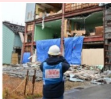
建築物の損壊状況（七尾市）
