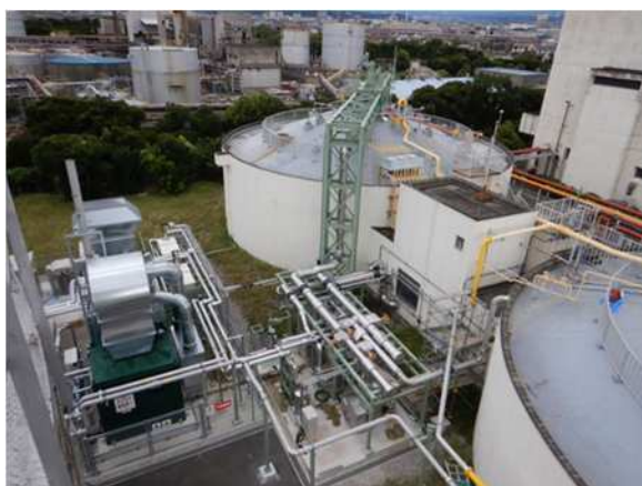
〔西部浄化センター消化ガス発電施設〕
